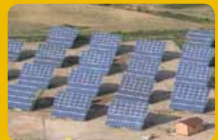
Instalaciones sobre suelo
